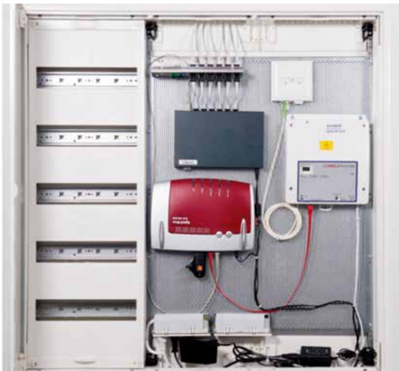
Beispiel eines Verteilkastens mit Telekommunikationsgeräten
