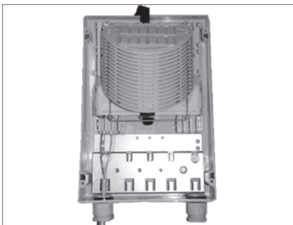
Abbildung 11: BEP mit ankommendem Glasfaserkabel
