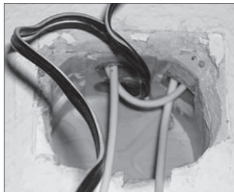
Abbildung 53: Bestehender Einlasskasten, der zur Abschlaufung dient. Um den Leistungsverlust auf den letzten Metern möglichst gering zu halten, sind biegeoptimierte Glasfasern der neuesten Generation der beste Investitionsschutz.
