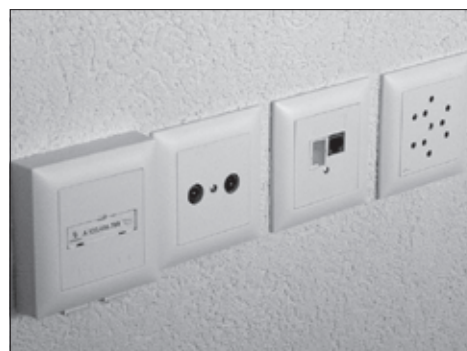
Abbildung 55: Im Wohnzimmer, hinter dem Büchergestell oder hinter dem Fernseher in der Nähe einer Wohnwand. Dies ist Fibre to the Home unter realen Bedingungen. Die Platzverhältnisse der einzelnen Wohnungen geben die Positionierung der FTTH-Datendose vor. Dabei gilt es zu beachten, dass die Platzierung nicht störend wirkt.
