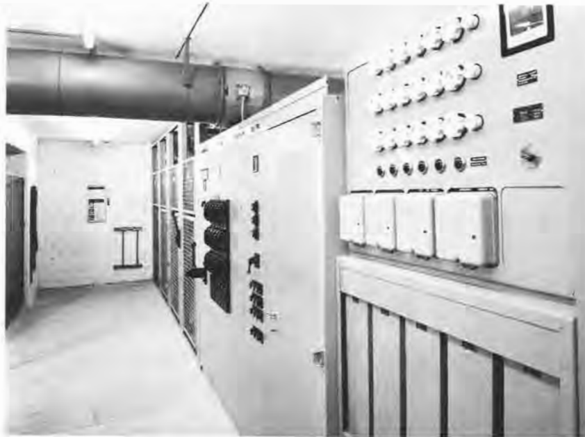
Transformatoren-Station Möbelfabrik rechts Kompensations-Anlage mitte Niederspannungs-Verteilung und Hochspannungsfelder links zwei Kabinen für Transformatoren
