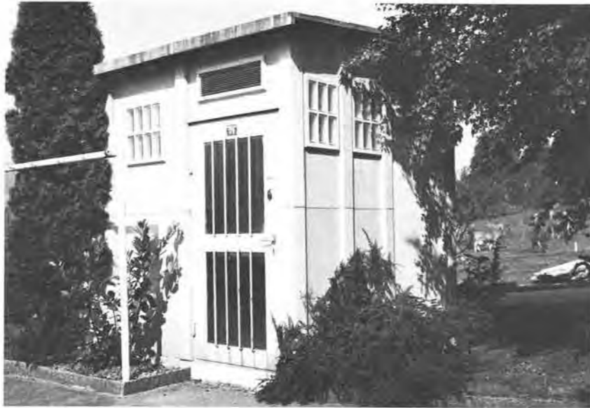
Transformatoren-Station Sonnenberg aus Bauelementen
