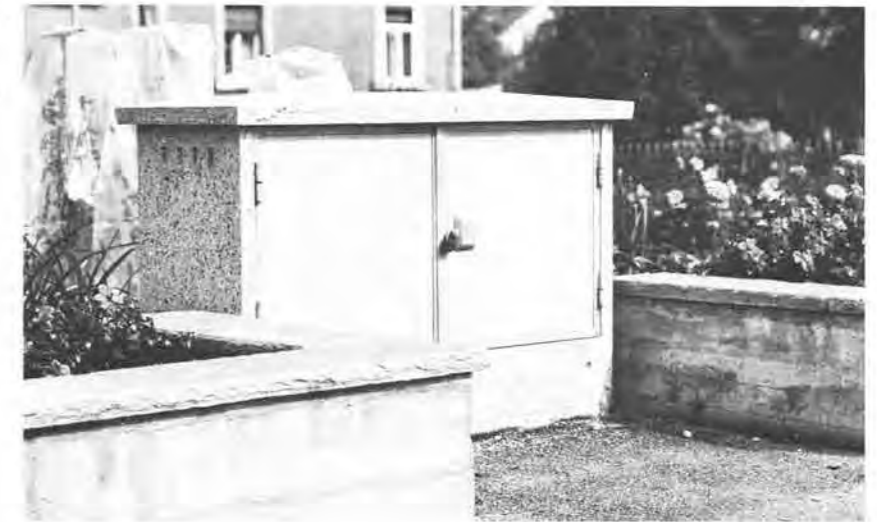
Niederspannungskabel- Verteilkabine Lindenstrasse/Breitestrasse
